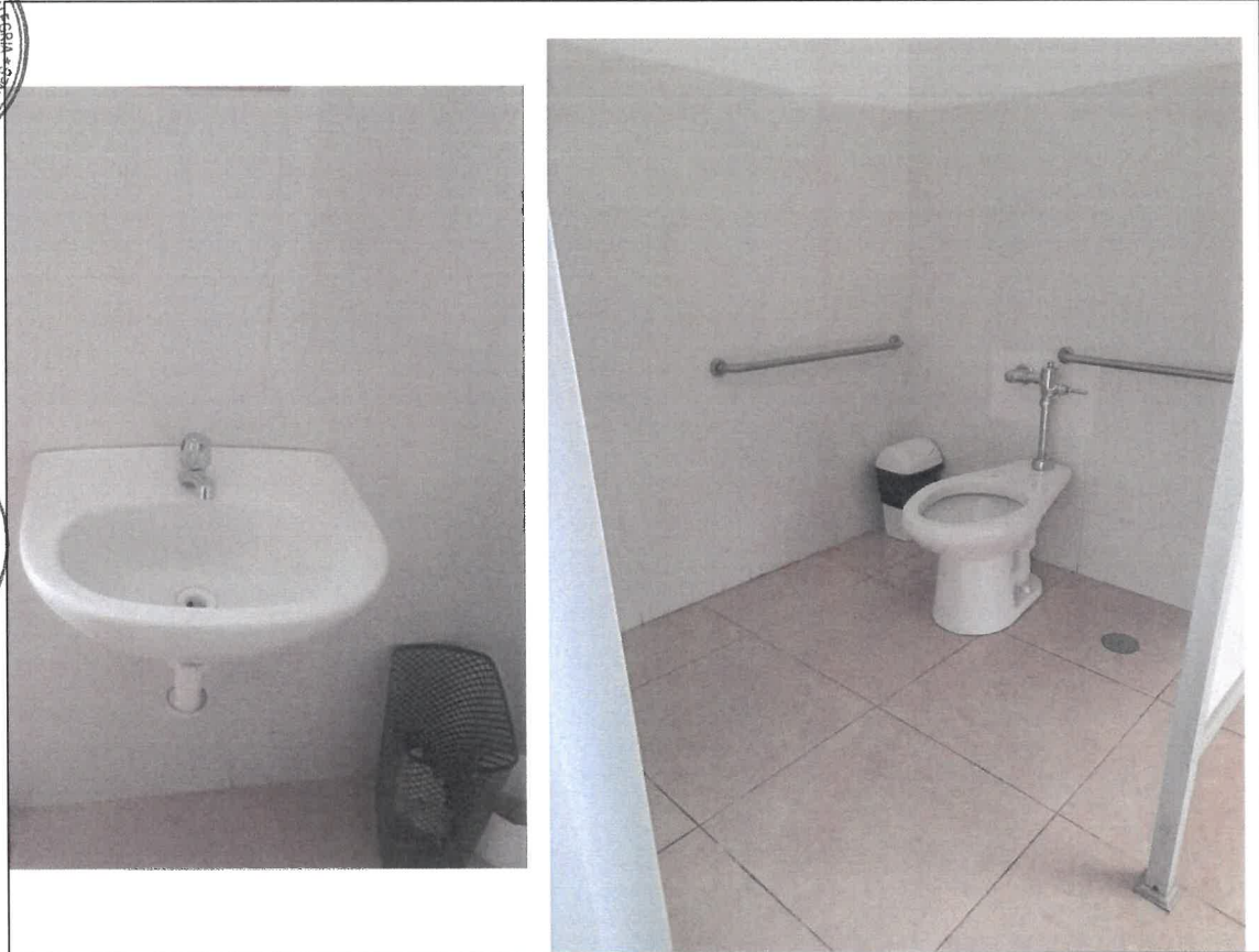
Lavamanos sin pedestal para accesibilidad e inodoro - Local Garcilaso
